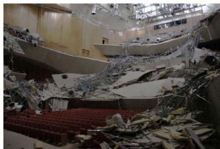
写真1 ミューザ川崎の被災 (川崎市中間報告書)
