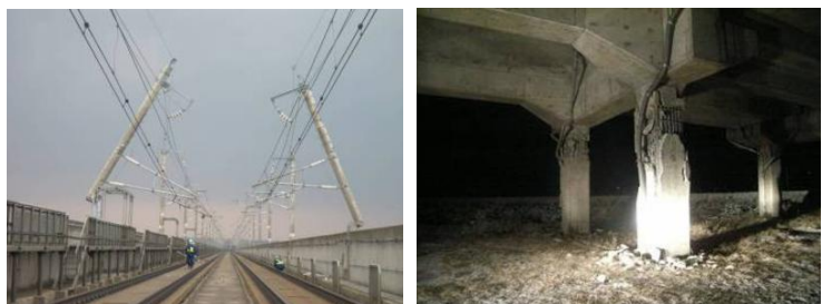
写真4 新幹線施設の電化柱損傷と橋脚損傷 (JR 東日本 HP)
